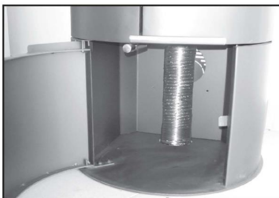
Uteluftsslangen bör kondensisoleras
