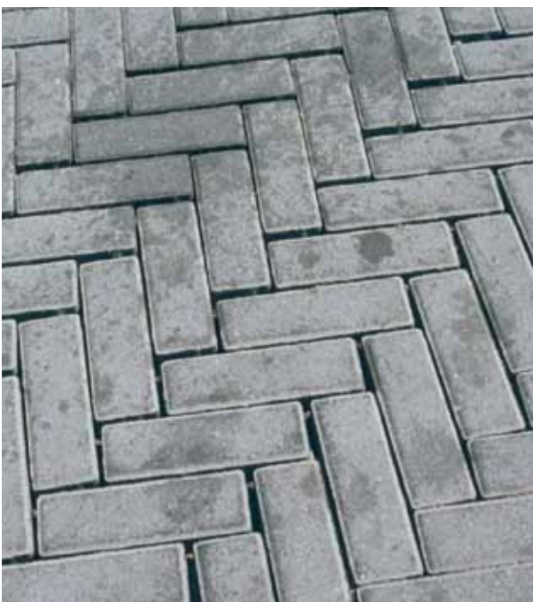
Otillräcklig fogfyllning leder till en instabil beläggning. Vid trafikbelastning glider stenarna runt och mönstret förskjuts.
